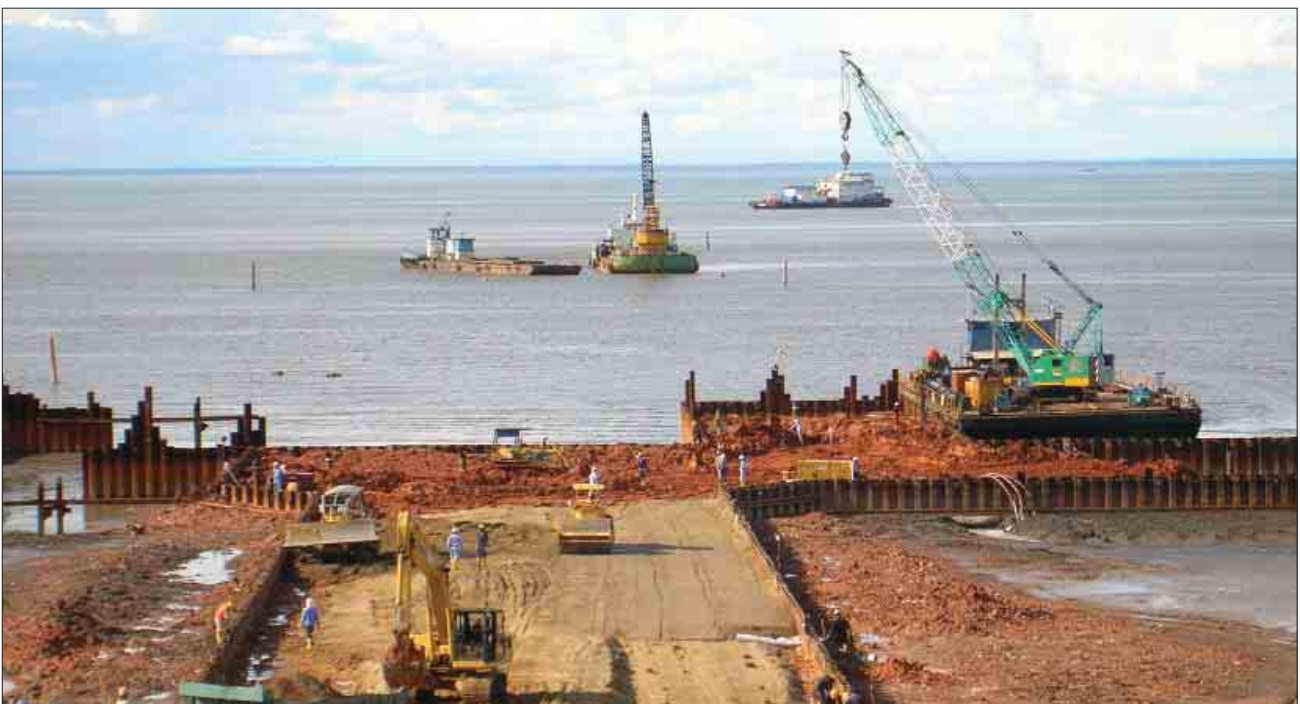
BP 'Tangguh' LNG project in West Papua
